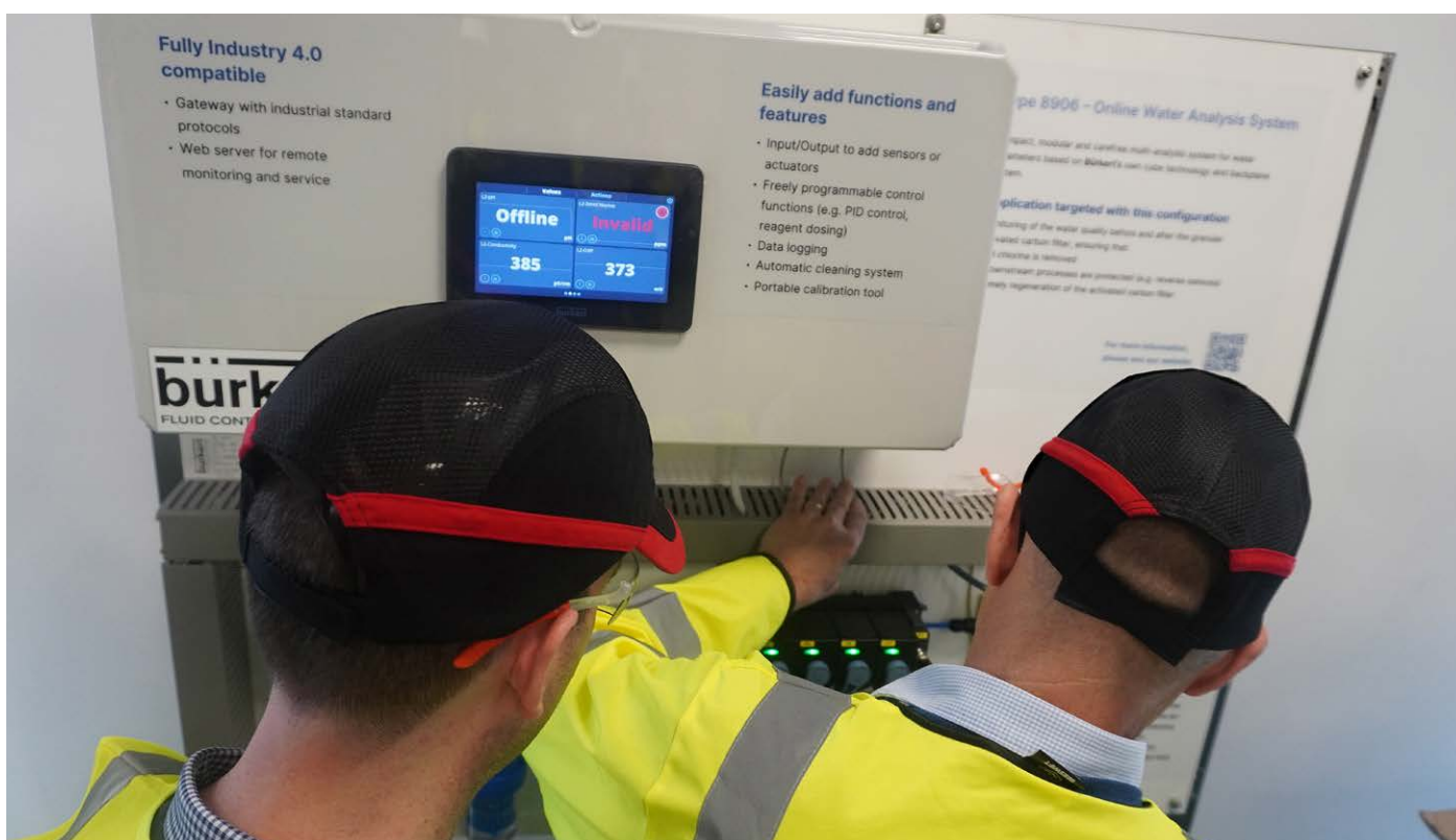
La instalación del compacto sistema de análisis de agua en línea fue un proceso sencillo.
